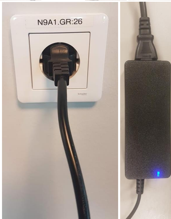
Foton från installation utav av ett boxsystem som ansluts till ett jordat uttag med 230 VAC @ 50 Hz via nätadapter.
